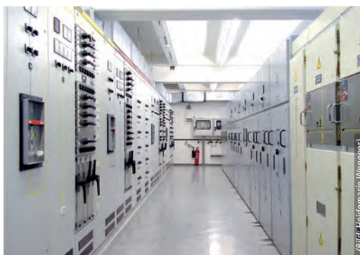
Blick auf die Niederspannungs-Hauptverteilungsanlage.
