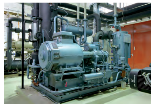
Die Kühlmaschinen sorgen für Kaltwasser.
