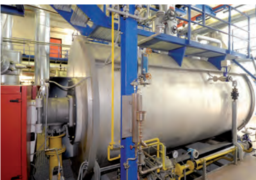
Einer der beiden großen Heizkessel.
